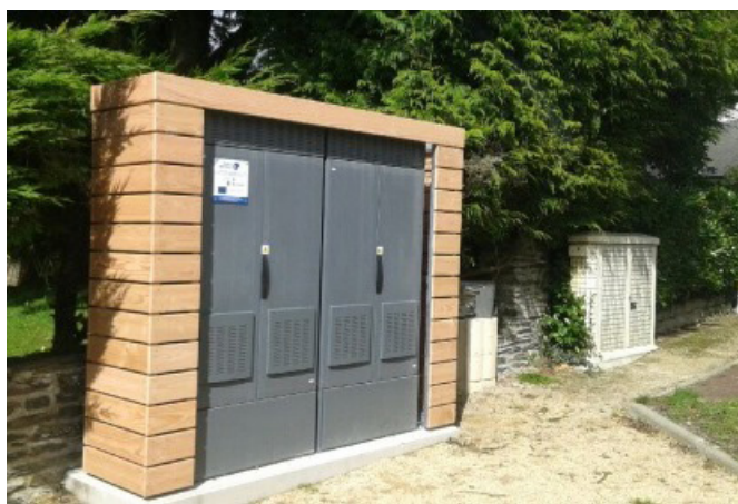
Armoire de montée en débit
