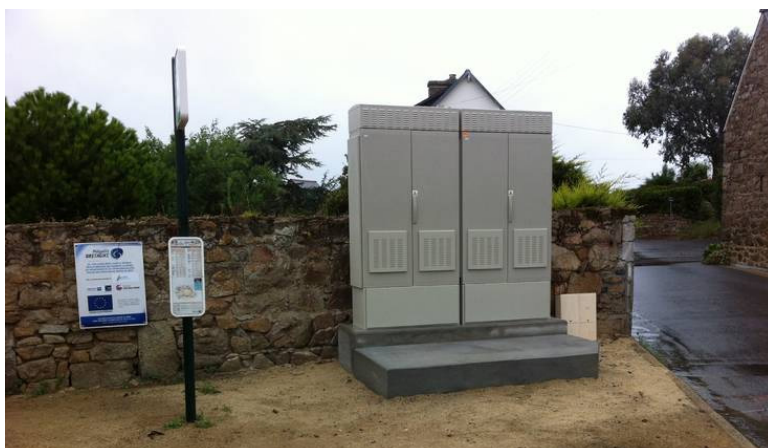
Armoire de montée en débit, déployée lors de la première tranche de travaux entre 2014 et 2015
