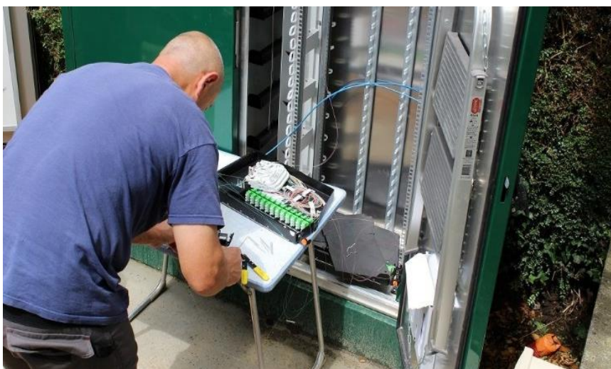
Photo d'une installation d'armoire à fibre optique
