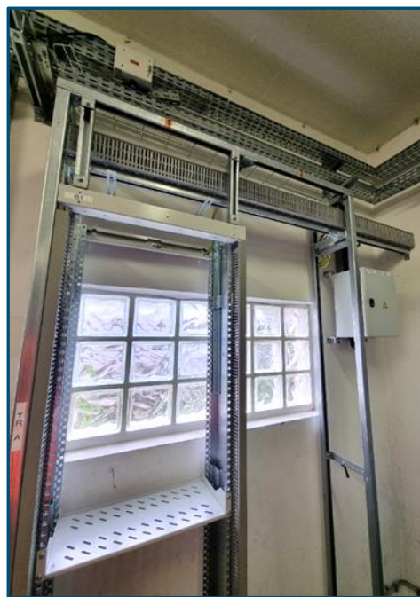
Baie pour OLT en place
