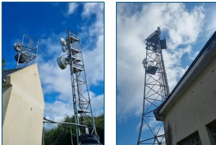
Pylônes TOTEM Plougonvelin et Molène
