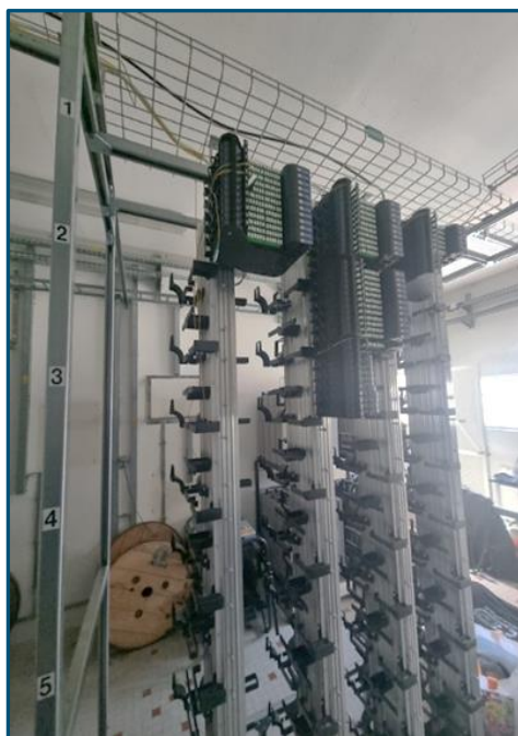
Fermes RTO installées
