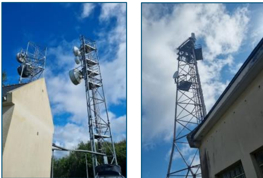
Pylônes TOTEM Plougonvelin et Molène
